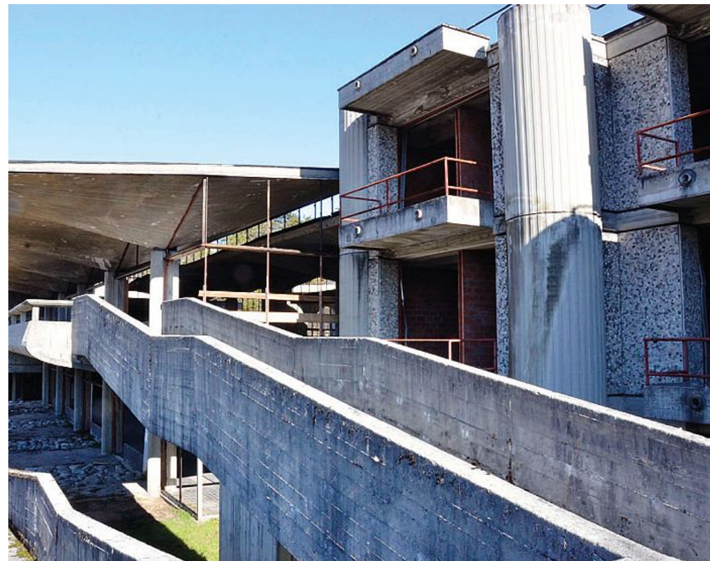
La struttura fatiscente dell'ex Anmil nel Bosco della Città: ora la giunta ha deciso di demolirla (foto Festi)
