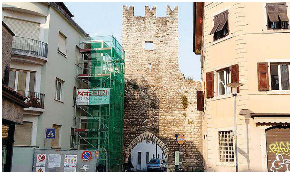
I ponteggi per la realizzazione dell'ascensore che è in fase di costruzione proprio vicino a Porta Santa Margherita
