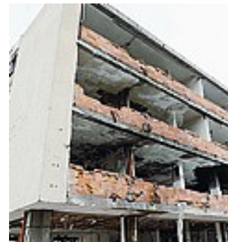
Ecomostro L'ex Frizzera: uno degli edifici che andranno abbattuti
