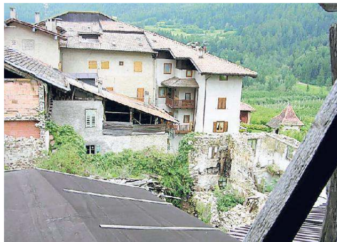
I ruderi dell'edificio di proprietà dell'Itea a Caldes
