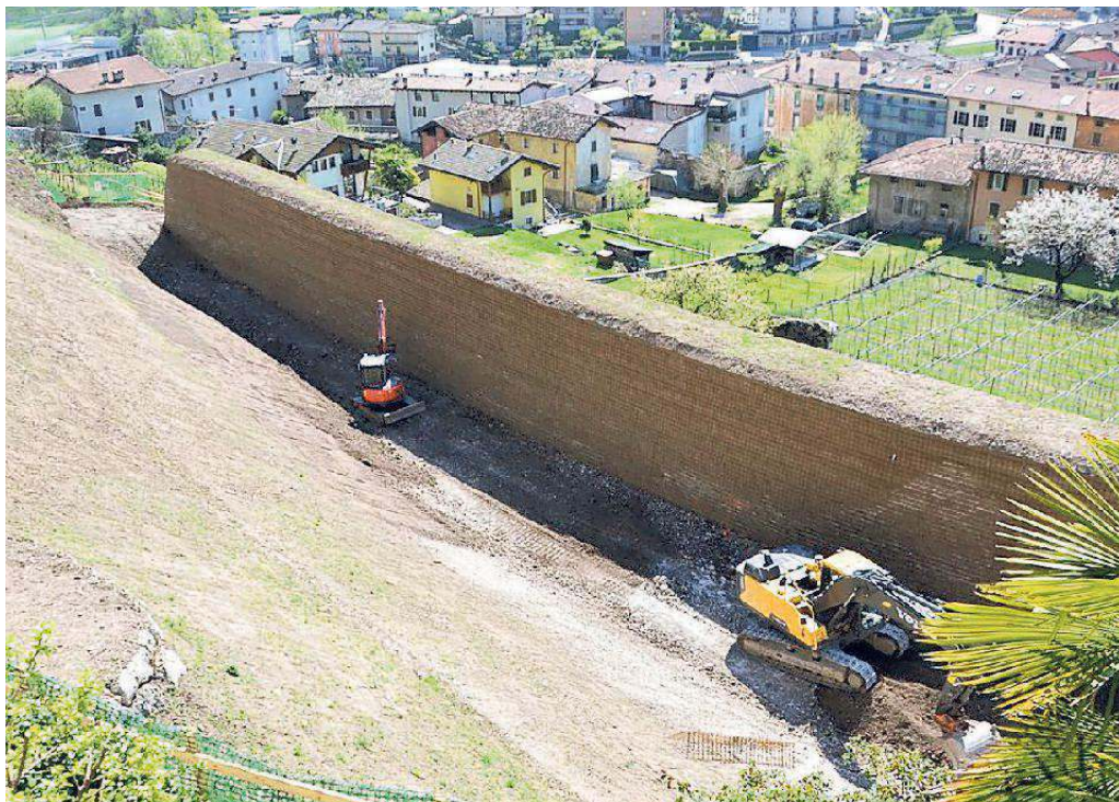
Il vallo tomo visto da monte: gli scavatori aiutano ad apprazzarne le dimensioni (foto Bruschetti)
