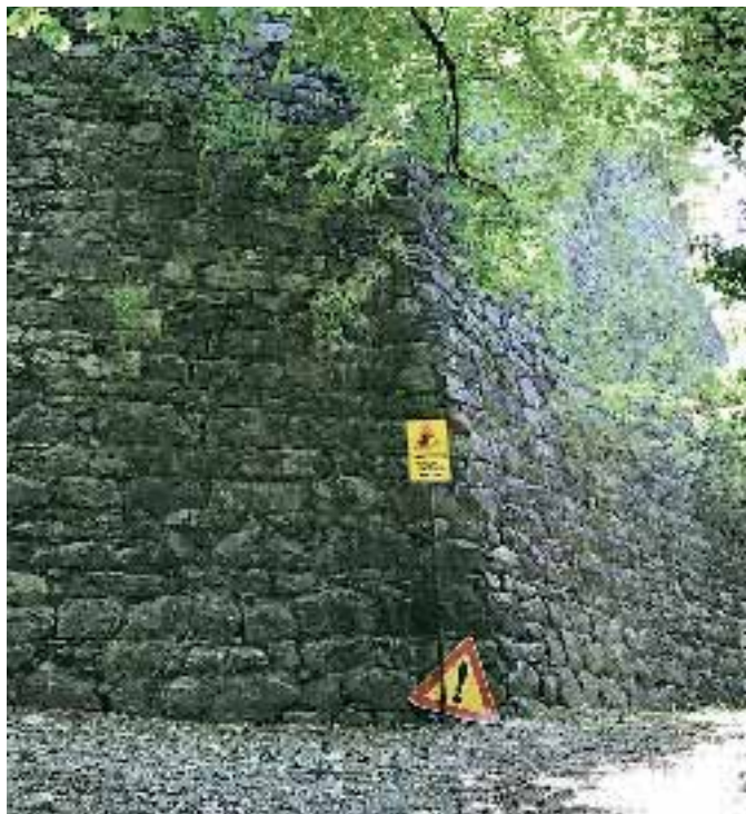
La segnaletica di "caduta massi" lungo la parete nord del castello
