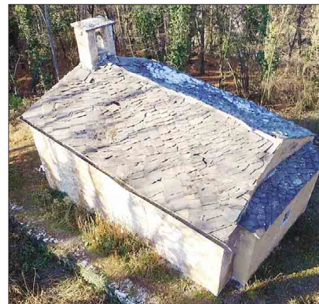
La copertura è da rifare e i materiali dovranno essere portati in elicottero
