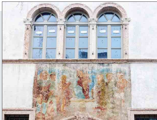
L'affresco soprastante il portale principale di palazzo a Prato, in via Maier 17, risale alla prima metà del Cinquecento ed è attribuito a Marcello Fogolino: restaurato anni fa, mostra tracce di dilavamento (foto G. Cardini)
