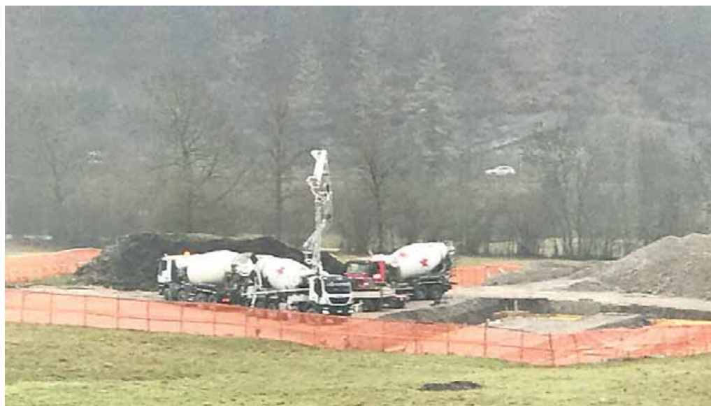
Il cantiere della stalla nella piana di Santa Lucia a Bezzecca: per il Consiglio di Stato i lavori possono ripartire
