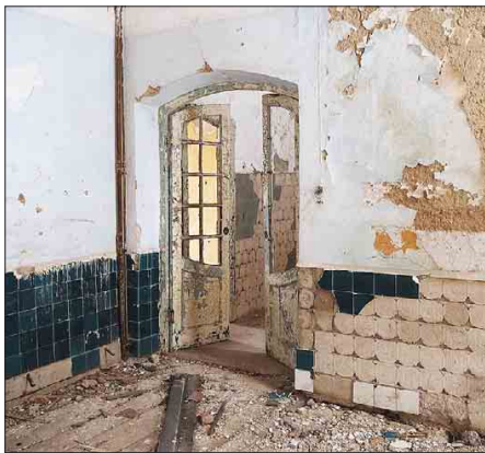
In alcune strutture la neve ha sfondato dei tetti
