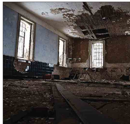
Alle caserme austro-ungariche il tempo ha creato gravi danni
