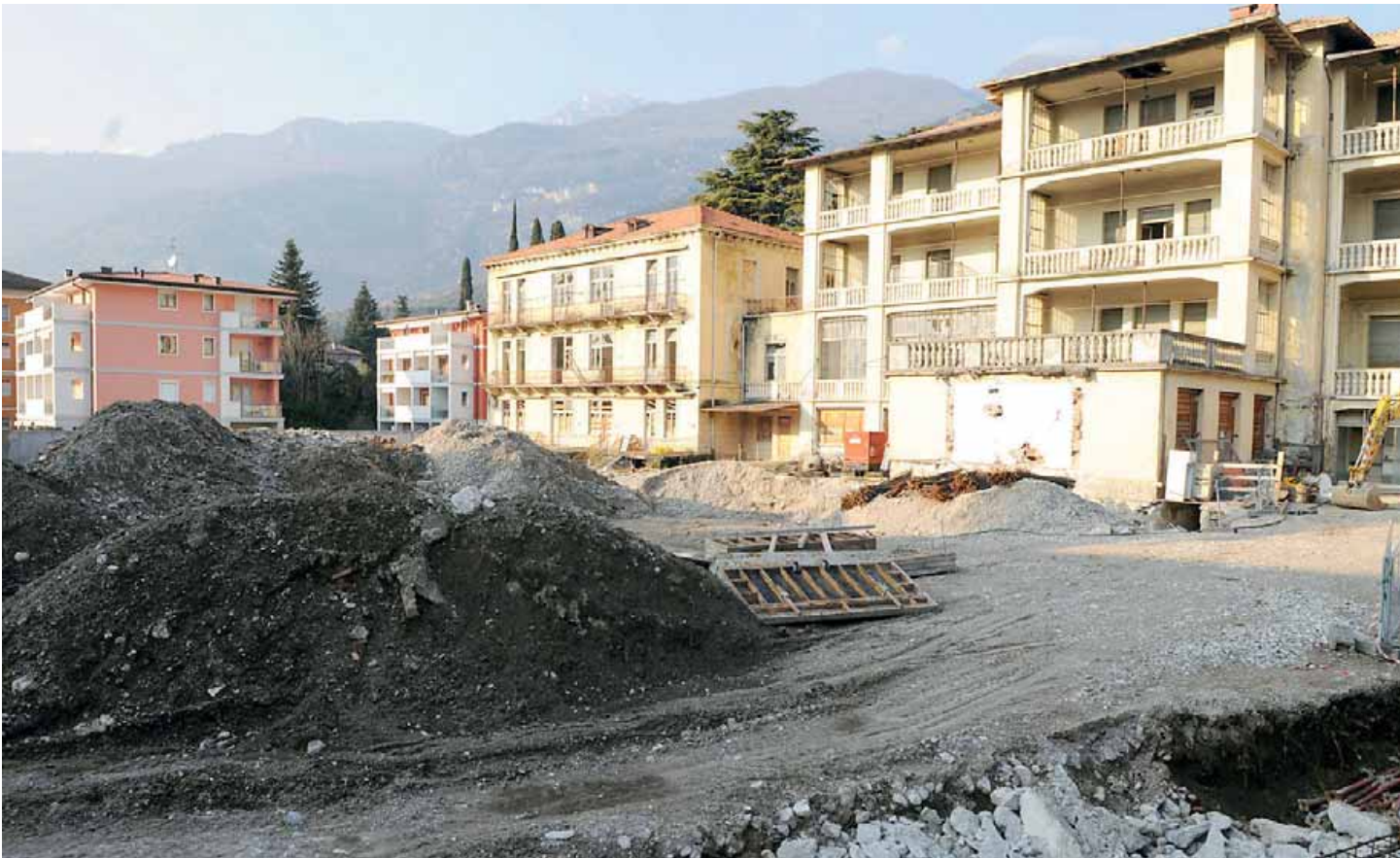
• Il cantiere del Quisisana abbandonato per due volte. Ora forse è possibile ricominciare i lavori e portare a conclusione il progetto
