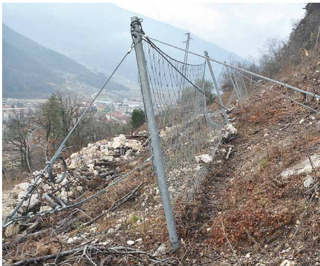
• La rete di protezione danneggiata dall'ultima frana a monte di Mori
