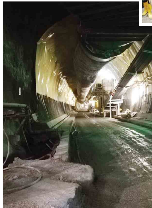
L'interno di una delle gallerie del cantiere per il tunnel di base del Brennero a Fortezza.
