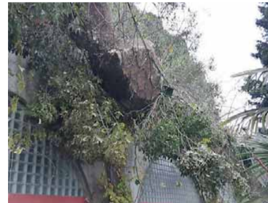
• Le reti della paramassi trattengono a fatica i blocchi
