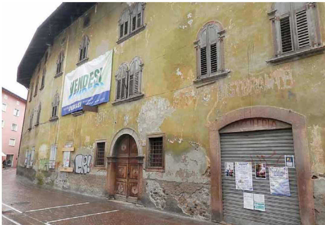
• La facciata dell'ex albergo al Cavalletto in stato di degrado in via Pennella
