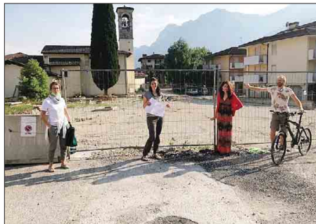
I lavori al piazzale davanti alla chiesa di San Marcello a Chiarano
