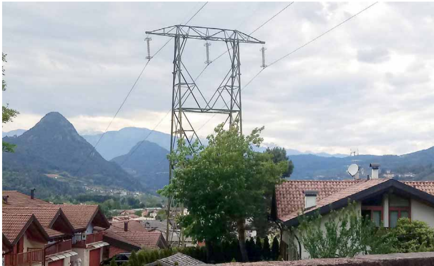
• Uno dei tralicci che attraversano anche la città di Pergine dove Terna ha scelto di mantenere le linee aeree invece di optare per il loro interrimento
