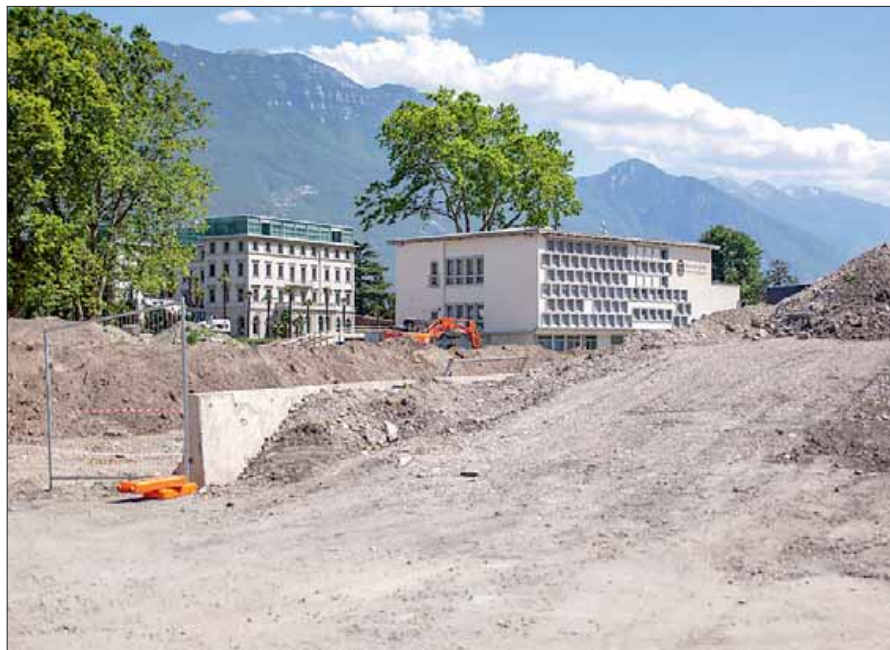
Il grande cantiere del nuovo Palazzo dei Congressi con annesso teatro comunale
