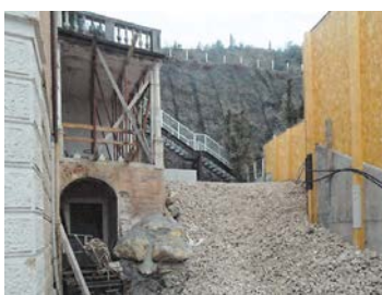
5. La distruzione del giardino della Villa e le opere abusive documentate dall'ispezione del febbraio 2020
