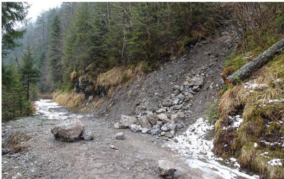
5 Erosioni e frane sulla viabilità
