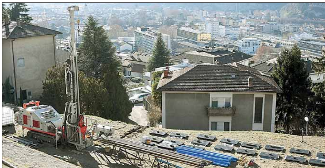
La trivella installata in via Missioni Africane ha già finito il suo lavoro ed è stata smontata
