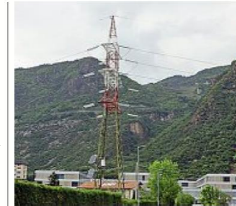
Rete Linea aerea per l'elettricità a San Maurizio
