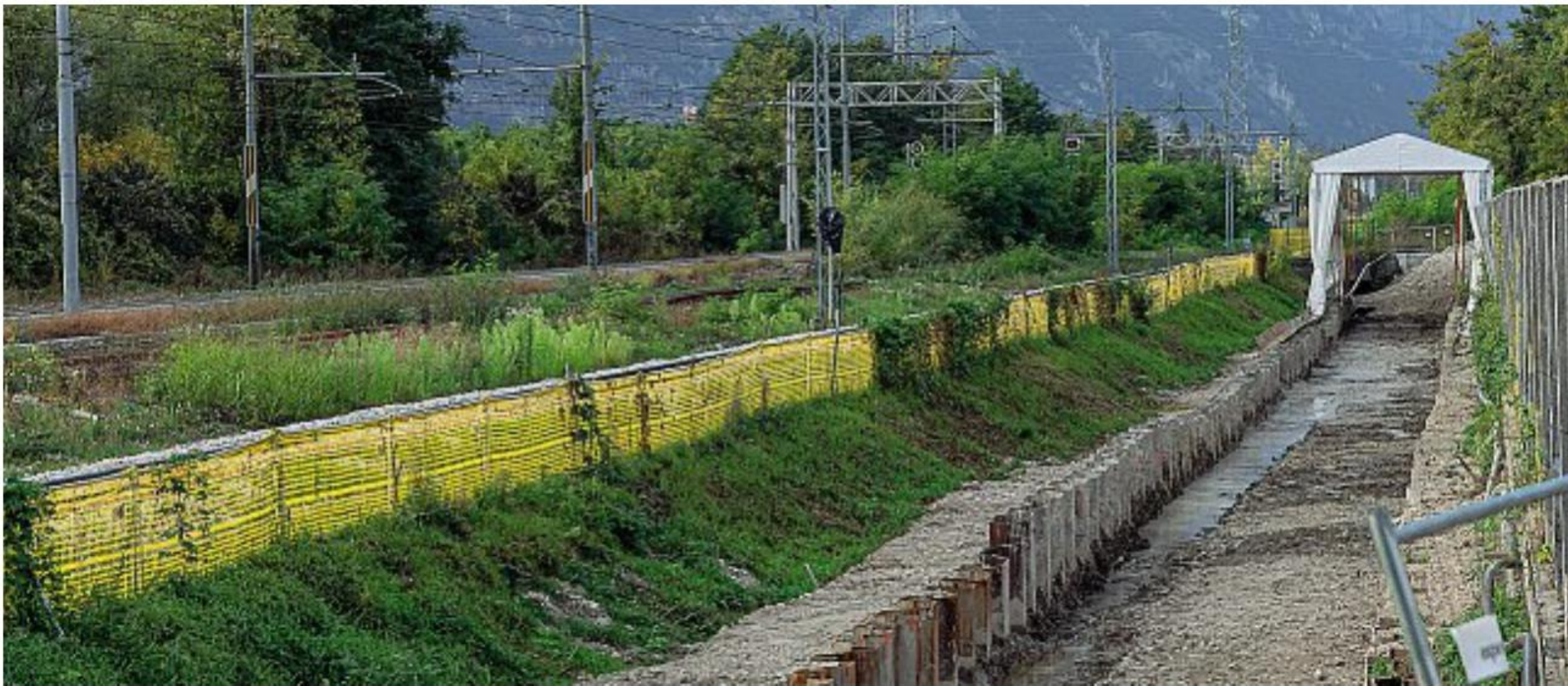
Prime operazioni Il cantiere allestito nella zona ex industriale della Carbochimica, a Trento nord, per la bonifica delle rogge inquinate: si parte dal rio Lavisotto (Foto LaPresse/Pretto)
