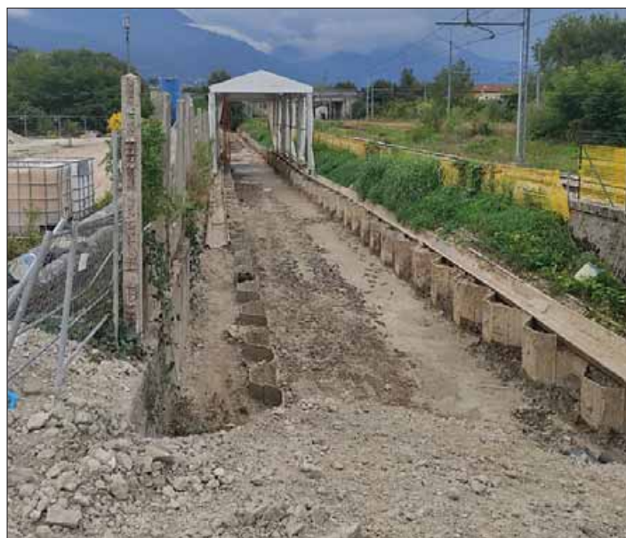
Il primo tratto del Lavisotto è pronto per lo scavo dei terreni inquinati
