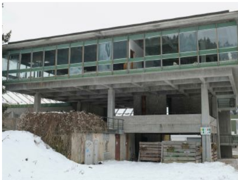
Ruderi Versano in condizioni fatiscenti gli immobili presenti a Malga Laghetto
