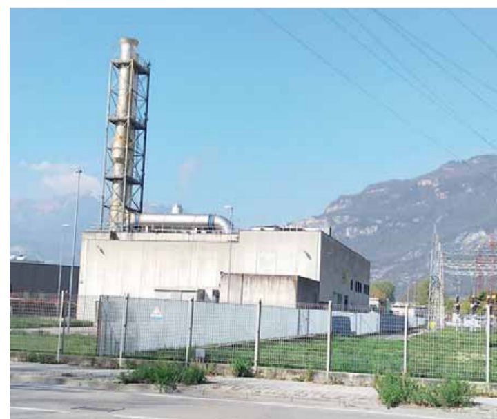
La centrale di cogenerazione che alimenta il teleriscaldamento
