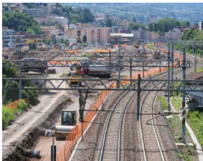
Cantiere Lavori in corso all'ex Scalo Filzi a Trento © Foto Marco Loss
