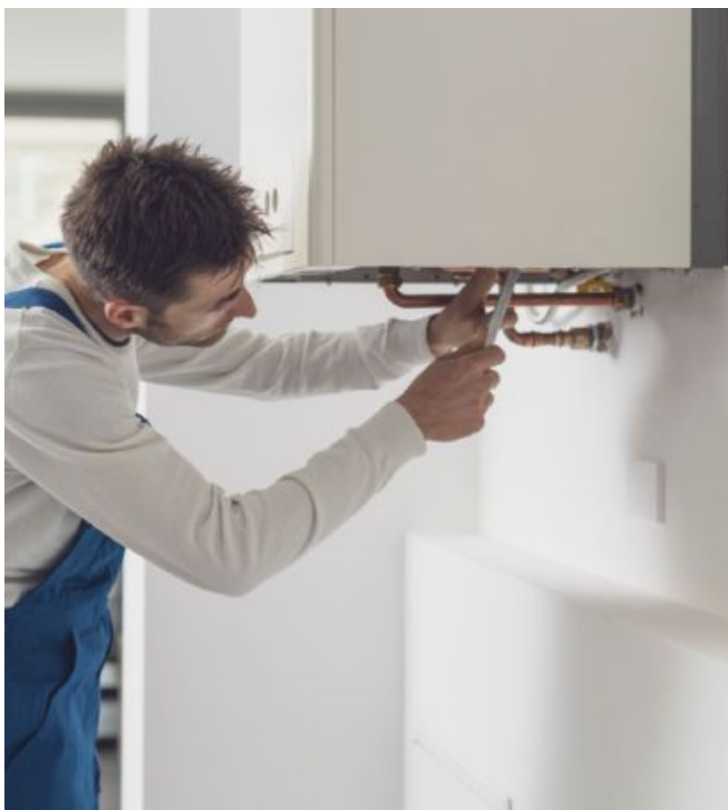
All'opera Il regolamento non consente lo scarico a parete necessario per installare le caldaie a condensazione
