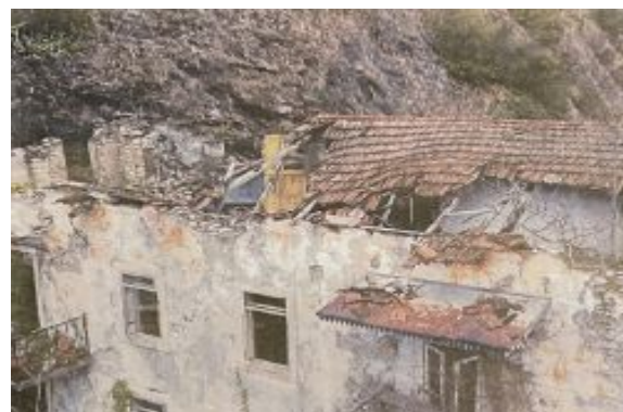
Dall'alto Il tetto crollato su se stesso dopo decenni di abbandono
