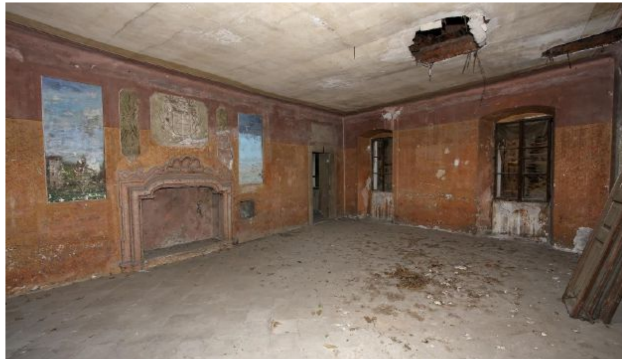
Patrimonio storico L'interno di palazzo Salvotti che sta andando in rovina
