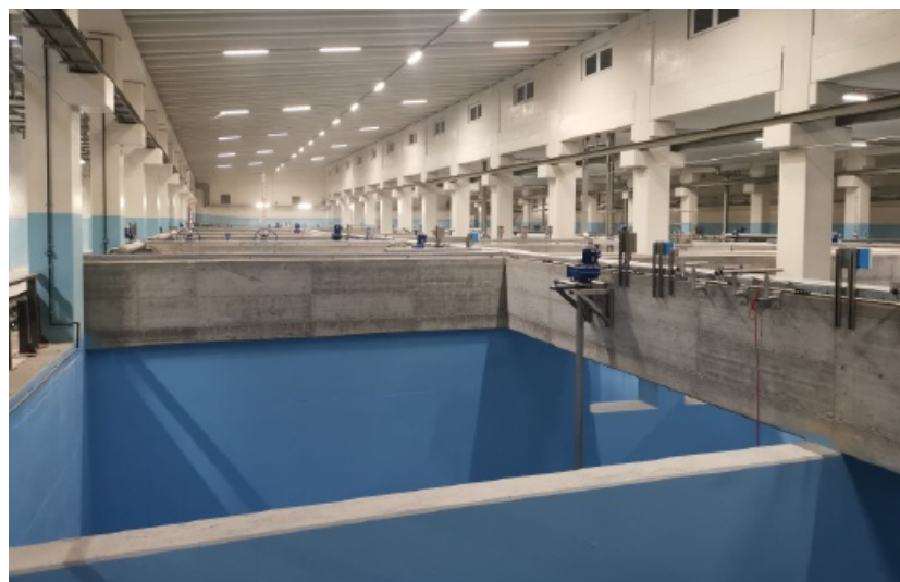
Depuratore L'interno dell'impianto Trento 3 che è ancora in ritardo
