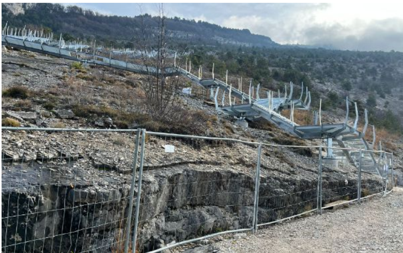
Cantiere I lavori per la realizzazione delle piattaforme di visita sul colatoio Chemini, ai Lavini
